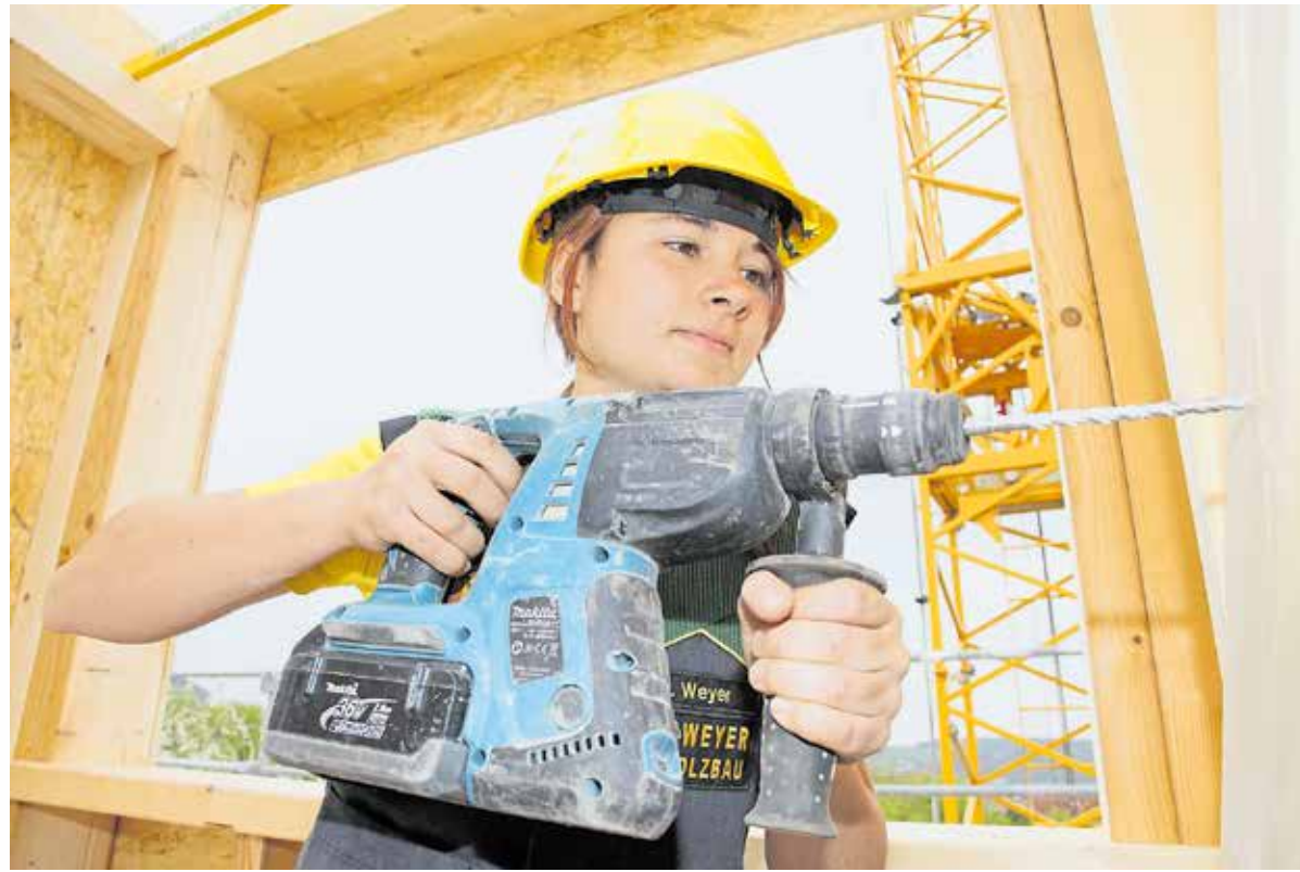
Fast 33 Prozent mehr Lehrstellen verzeichnet das Zimmererhandwerk im Kammerbezirk Chemnitz im Vergleich zum Vorjahreszeitpunkt. Zwei der 77 neu eingetragenen Zimmerer-Lehrverhältnisse beginnen auch Mädchen.
